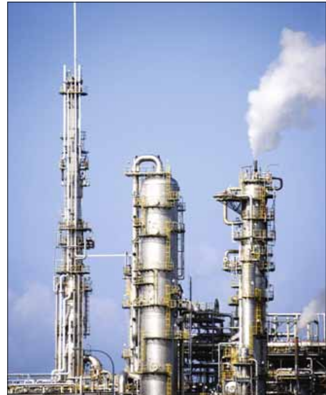
Kolonnen in einer Raffinerie
